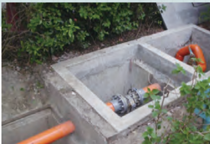
台達電子工業股份有限公司台南分公司二期新建工程：污水排放流井。
