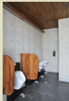
歐萊德國際股份有限公司 廠房新建工程：腳踏式沖水省水小便器設備。
